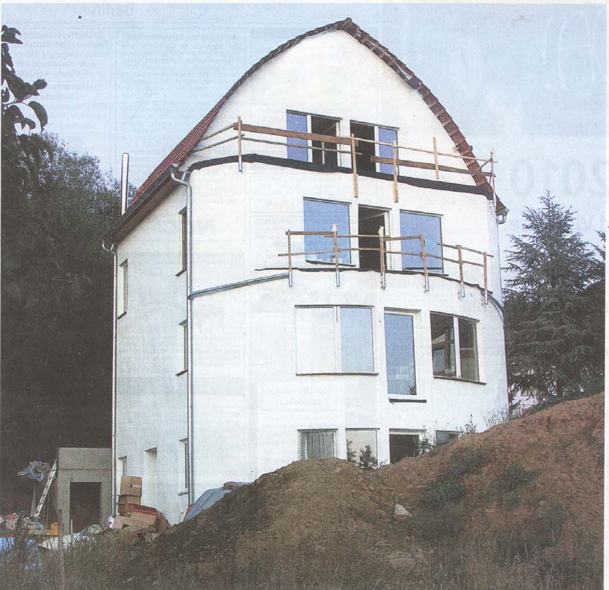
Strohballen statt Mauersteine: Der Weg vom Feld zum Bauplatz war nicht weit. Die 1 Meter dicken Ballen werden bockkant in die Gefache gesetzt. Der Bau wird bei unbeständigem Wetter zum Wettlauf mit der Zeit, denn das Stroh darf nicht nass werden. Im Innenraum dienen Weichholzfaserplatten als Träger für den Lehmputz (rechts, 2. Bild von oben). Die Baustoffe sind nicht giftig, aber staubig (rechts, 3. Bild von oben).
