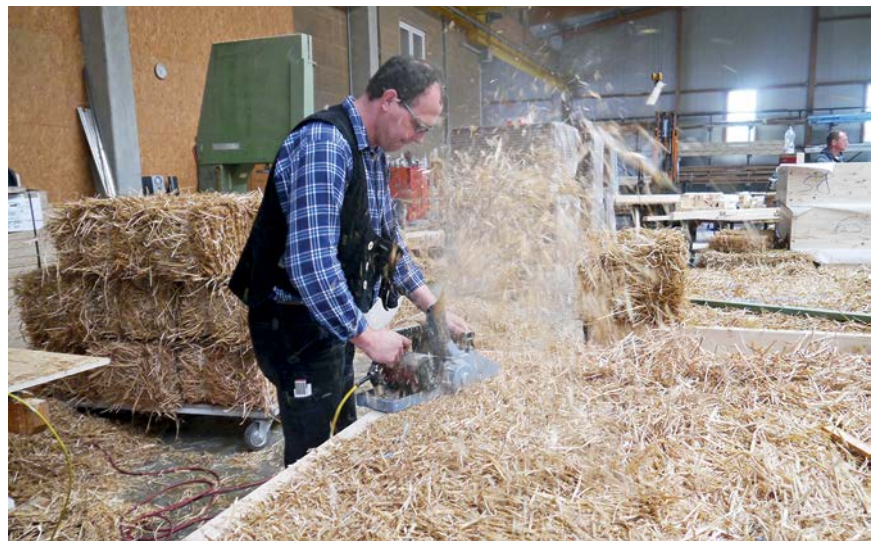
Die Wandelemente wurden in der Zimmerei vorgefertigt, die Strohballen eingepasst und abgeholt
